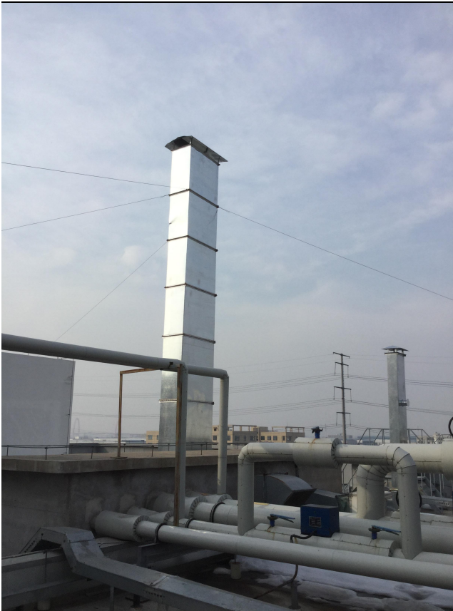
拣选除尘排气筒
