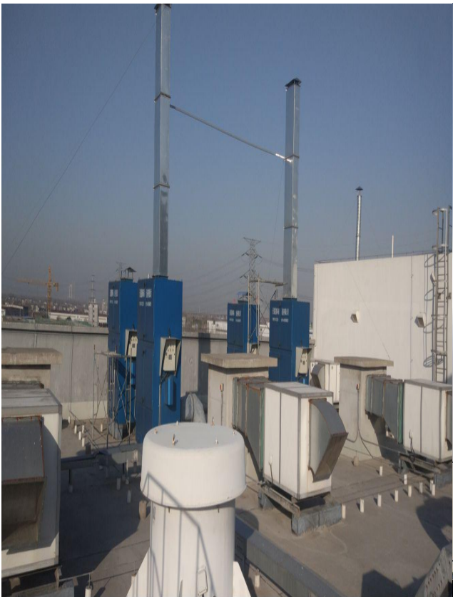
投料除尘器排气筒
