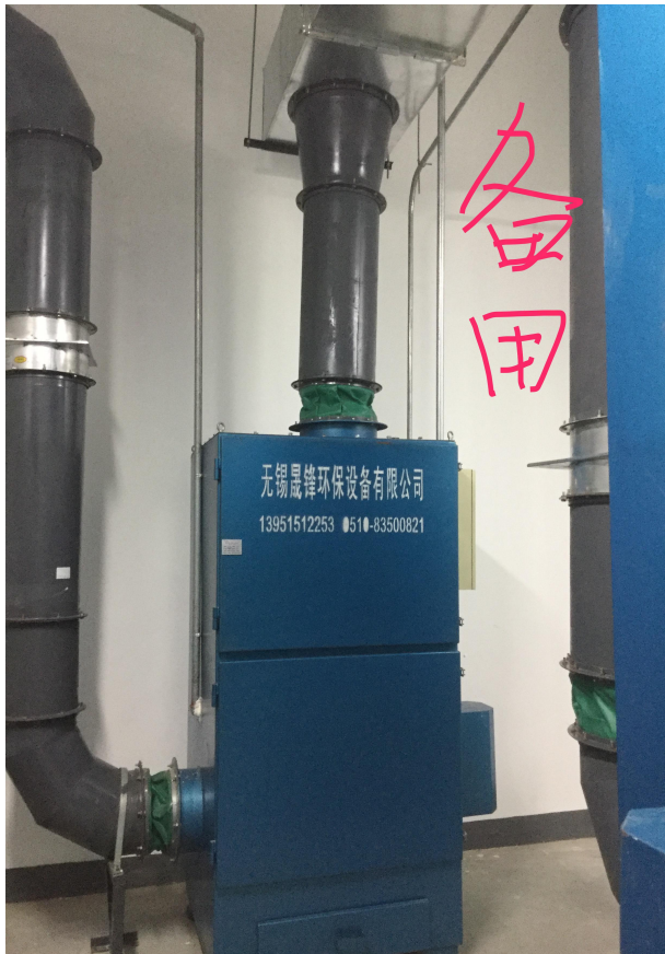
生产车间备用除尘器
