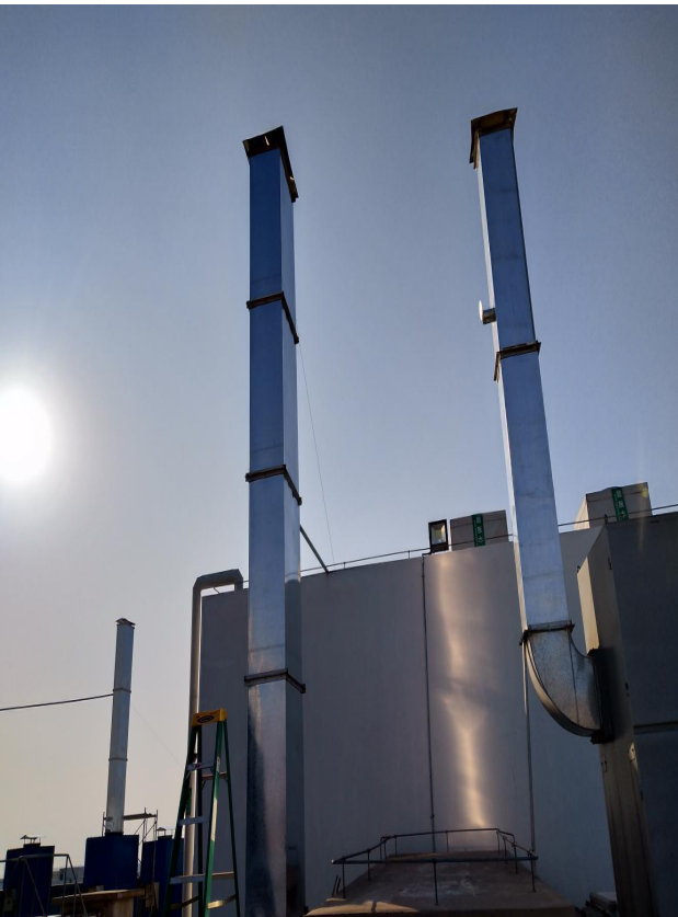
粉碎和FBG除尘器排气筒
